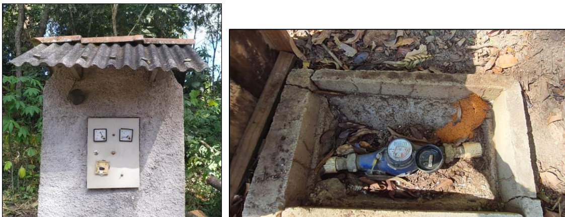
Figura 35: Horímetro e hidrômetro instalados para o poço de captação subterrânea.
